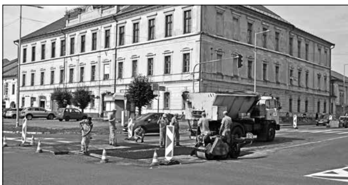
Po viacerých urgenciách sa podarilo dosiahnuť opravy prepádajúcej sa cestnej komunikácie na najväčšej križovatke v našom meste. Opravy realizovalo Stredisko Správy ciest KSK v Spišskej Novej Vsi.
